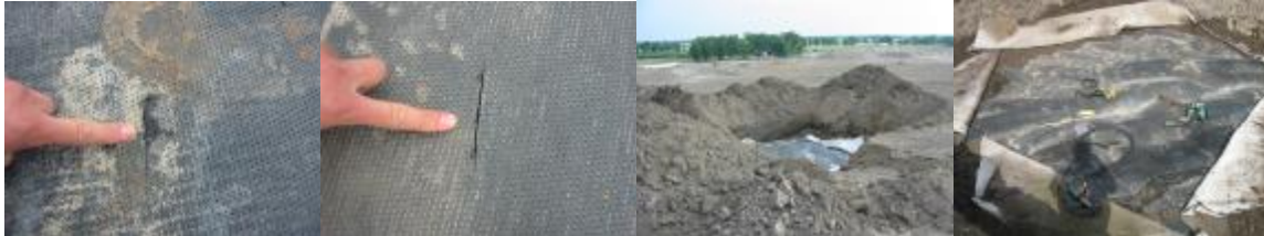
Figuur 5: Foto's lekken in folie met vrijgraven locatie en reparatie
